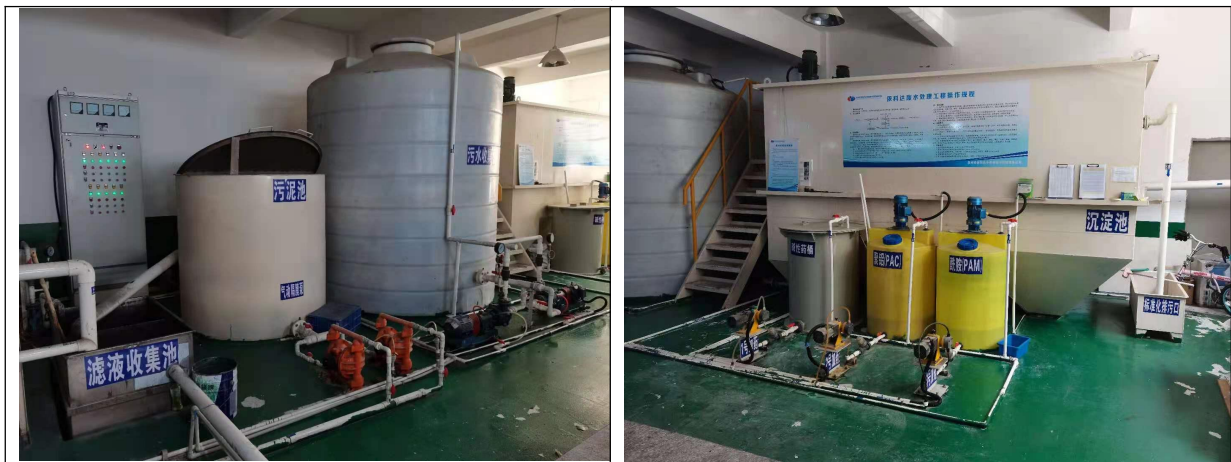
图 3-2 项目危废水处理设施图片
